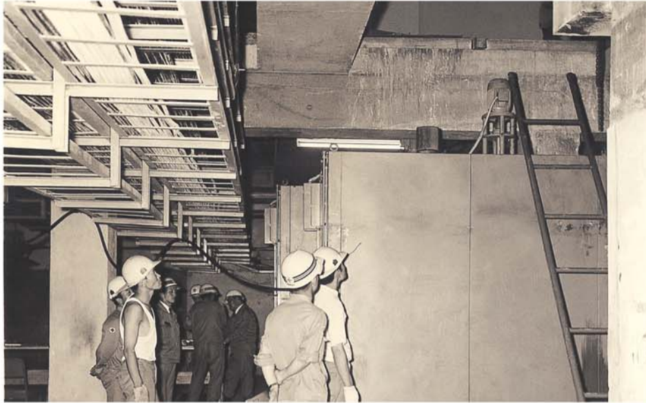
1972년 7월 임직원들이 조업을 시작하자 한 달이 채 안된 포항제철소 중후판공장에서 발생한 변압기 사고현장을 살펴보고 있다.
